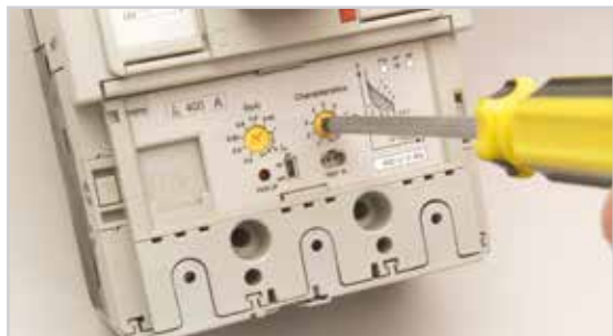
Nastavenie predvolby pre 400 A Etibreak 2MCCB s elektronickým ochranným modulom
